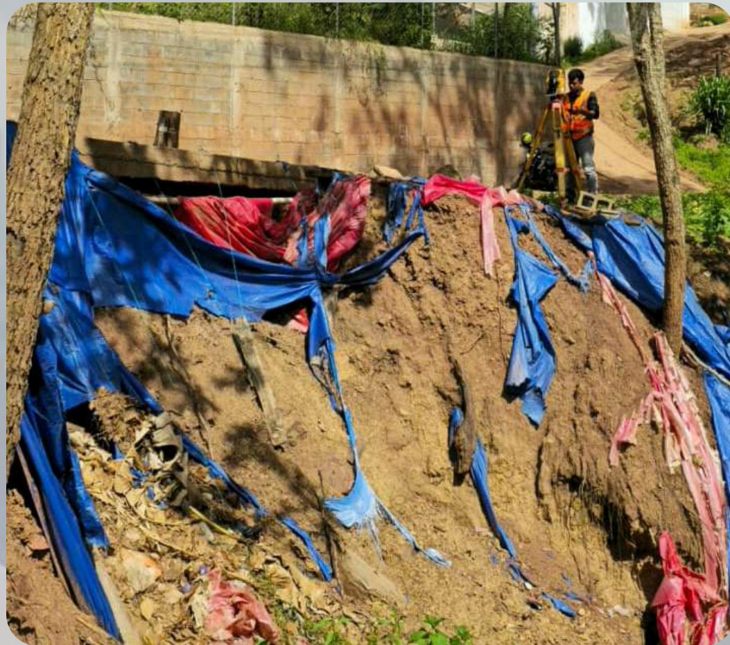
Socavon en carretera, Sabanetas, Santa Lucía.
